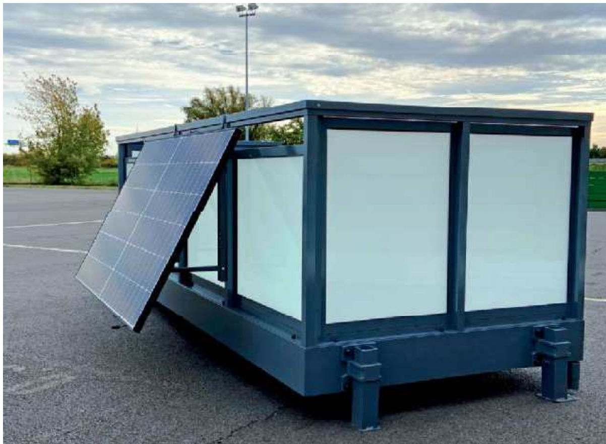
Beispiel eines fachmännisch montierten Balkonkraftwerkes
